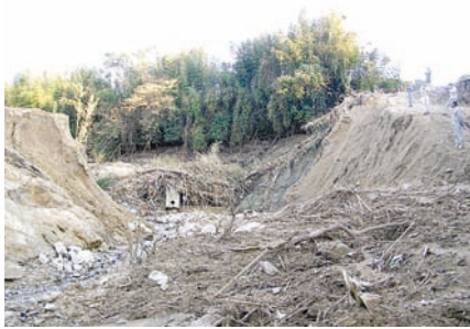
写真-5 淡路島北淡地区・育波川のため池土堰堤の崩壊
