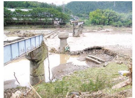
写真-2 足羽川に架かるJR越美北線鉄橋の流失
