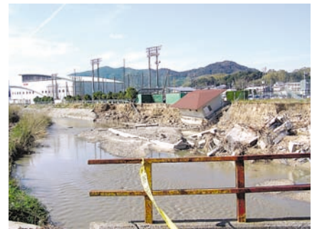
写真-3 溢水氾濫流による洲本川の被災状況
