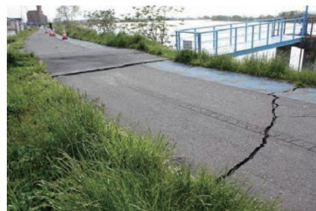
図-3 旧北上川右岸堤防に入った亀裂と沈下の様子 (2011年5月、水文循環工学分野撮影)
